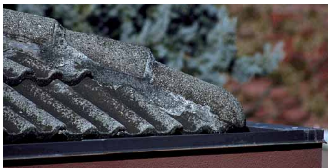
1. Copertura degli anni '70 e '80 realizzata con tegole in cemento colorate superficialmente, che, a distanza di anni, presenta zone nelle quali risulta visibile il colore di base sotto lo strato pigmentato.
